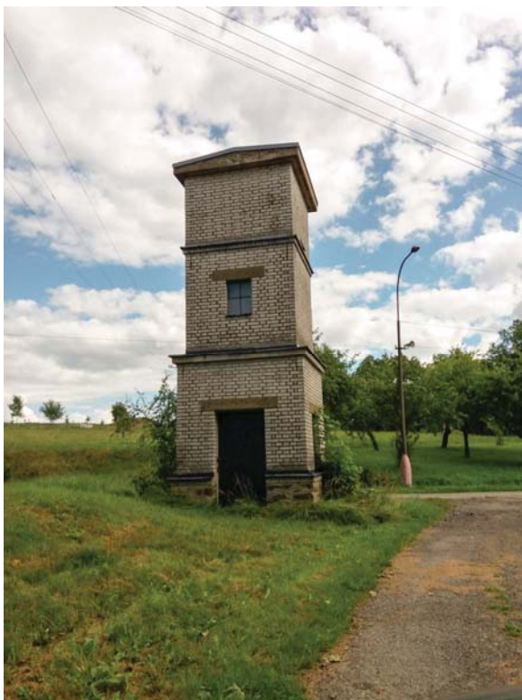
Číslo kontroly 72 Body B Název Trafostanice
